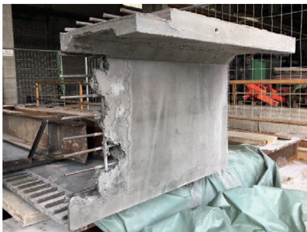
Abb. 9: Randbord Musterelement mit Fehlstellen infolge Entmischungen/Verstopfungen
