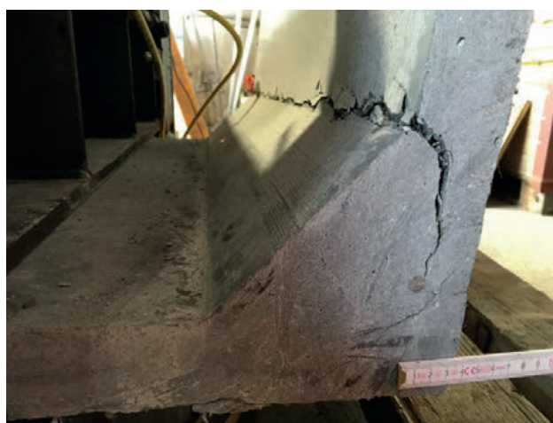
Abb. 12: Bruch im Randbord infolge des Belastungsversuchs
