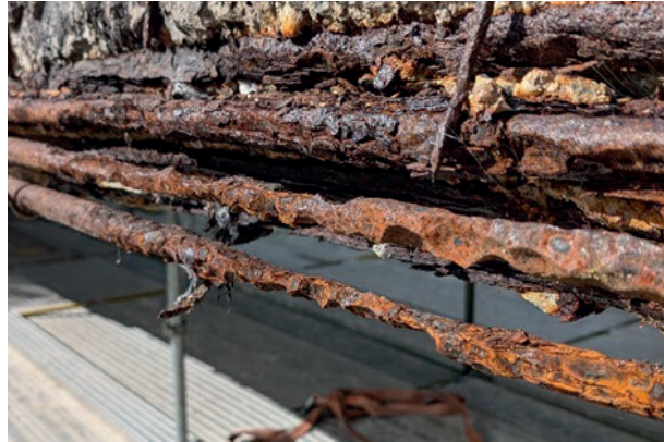
Abb. 6: Korrodierte Bewehrung des Untergurts
