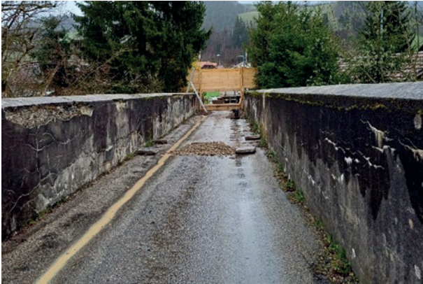
Abb. 5: Beschädigter Verputz und Fahrbahn
