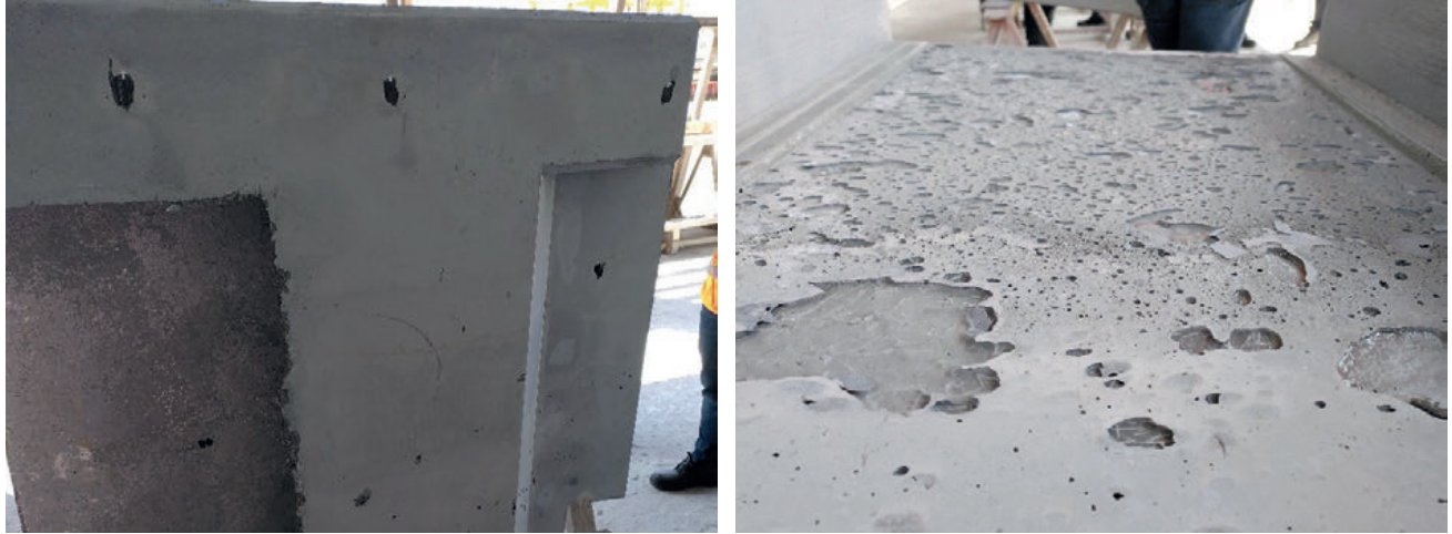
Abb. 8: Ergebnisse der Vorversuche bei der Bahnbrücke mit den Distanzhaltern, in welche der UHFB nicht penetrieren konnte (an der Aussenseite des Trogquerschnitts im Auflagerbereich, linke Abbildung) und der schlecht entlüfteten Konterschaltung (im Bereich des Werkleitungskanals, rechte Abbildung)
