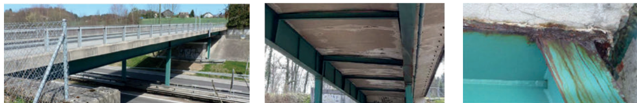
Fig. 2 : Ancien PS de Chenaule, démoli en 2024 : vue depuis la culée côté lac, vue sous le tablier, détail de l'interface détériorée entre la poutre maitresse et la dalle en béton
