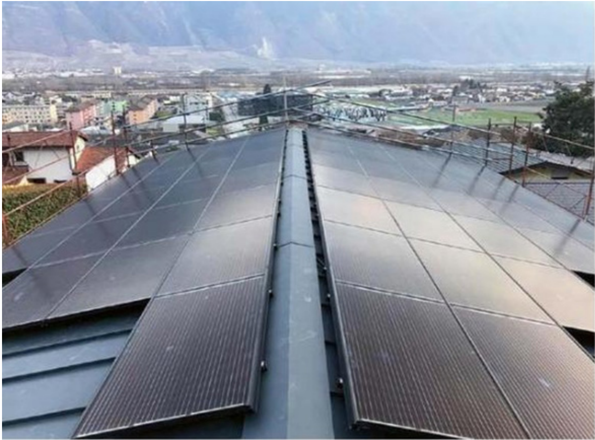
40 % des caves ayant répondu à l'enquête sont aujourd'hui équipées d'une installation photovoltaïque.
